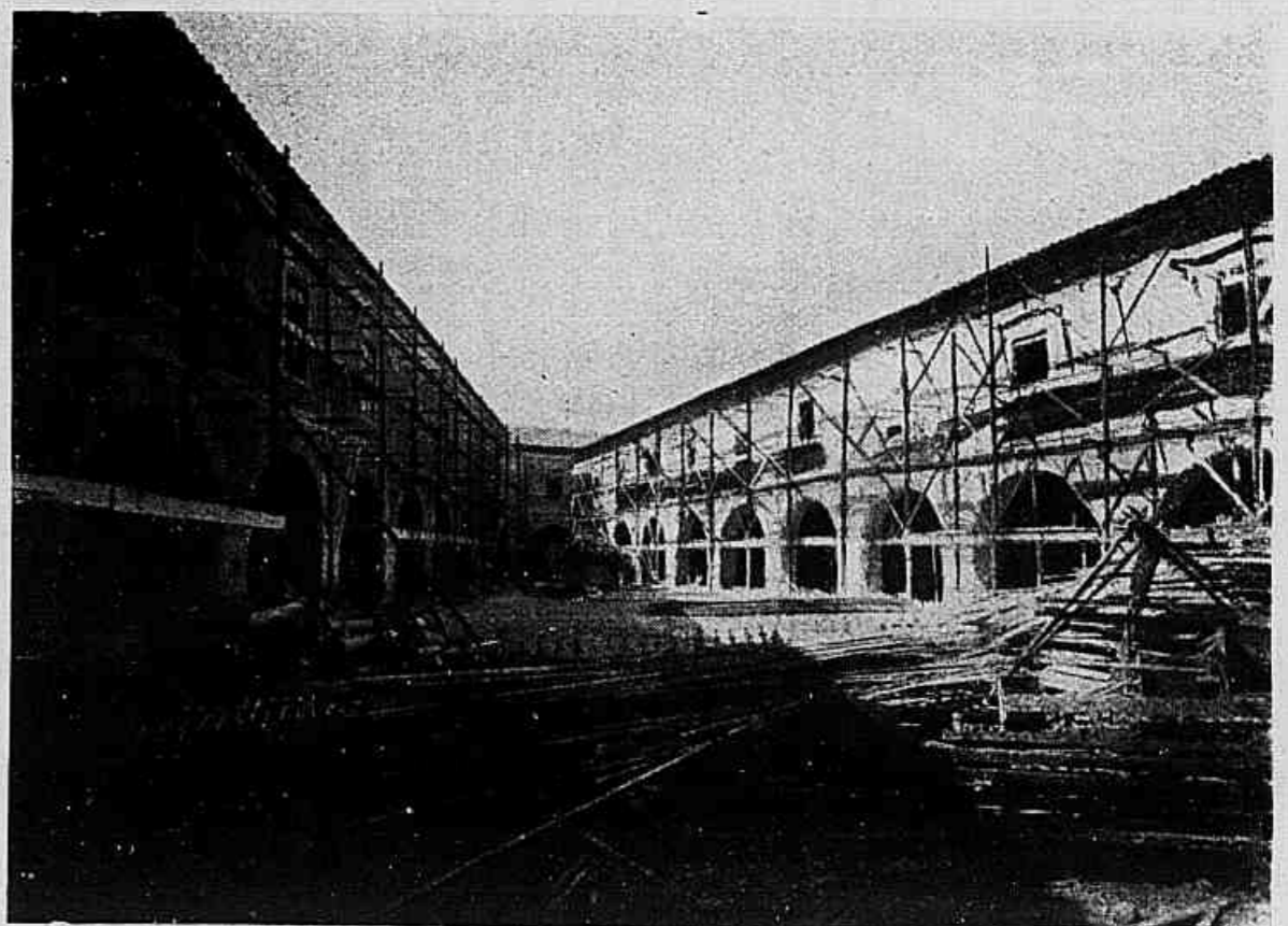
RESTAURAÇÃO DO VELHO QUARTEL DO MOURA, PARA PALACIO DAS INDUSTRIAS, DA EXPOSIÇÃO NACIONAL DE 1922.
