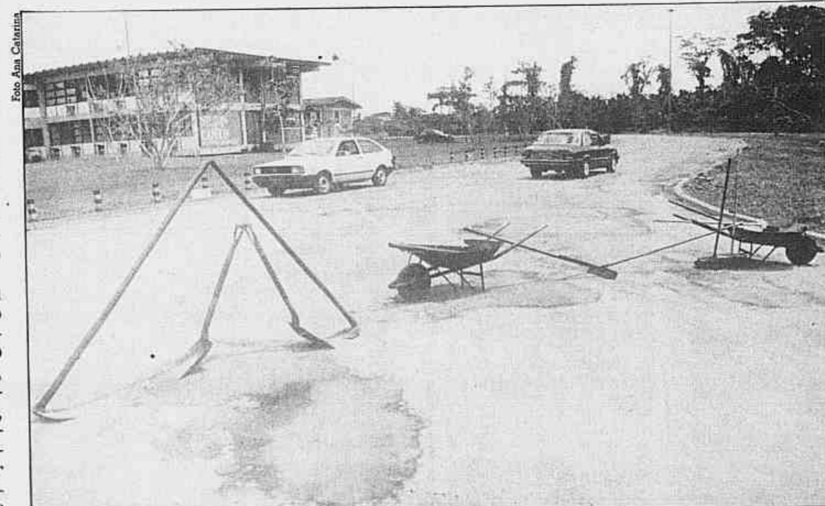
A Prefeitura de Belém já começou os trabalhos de restauração do sistema viário do campus da UFFa. Por enquanto, será desenvolvida a operação tapa-buracos. (Página 4)
