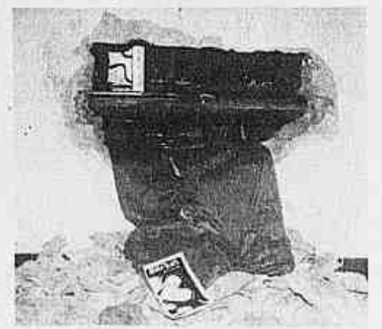
O buraco na parede interna
